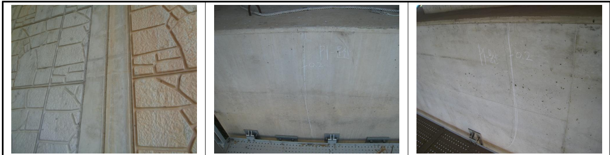
① 하부구조 균열(0.3mm 미만) 등 - 진전 여부확인
